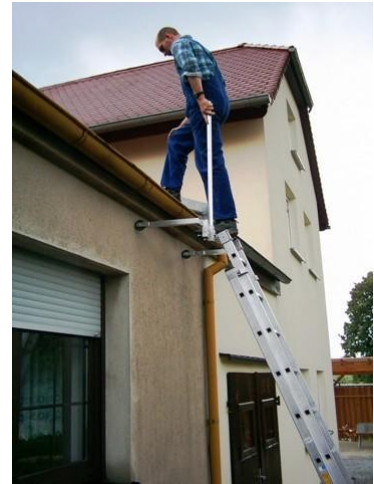
Abbildung 03: MFS-AT als Distanzhalter und Dachaufstieg
